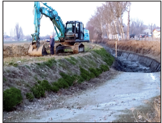
2022 Sbancamento del letto del Canale a monte della località Mora, eseguito dal Consorzio Burana
